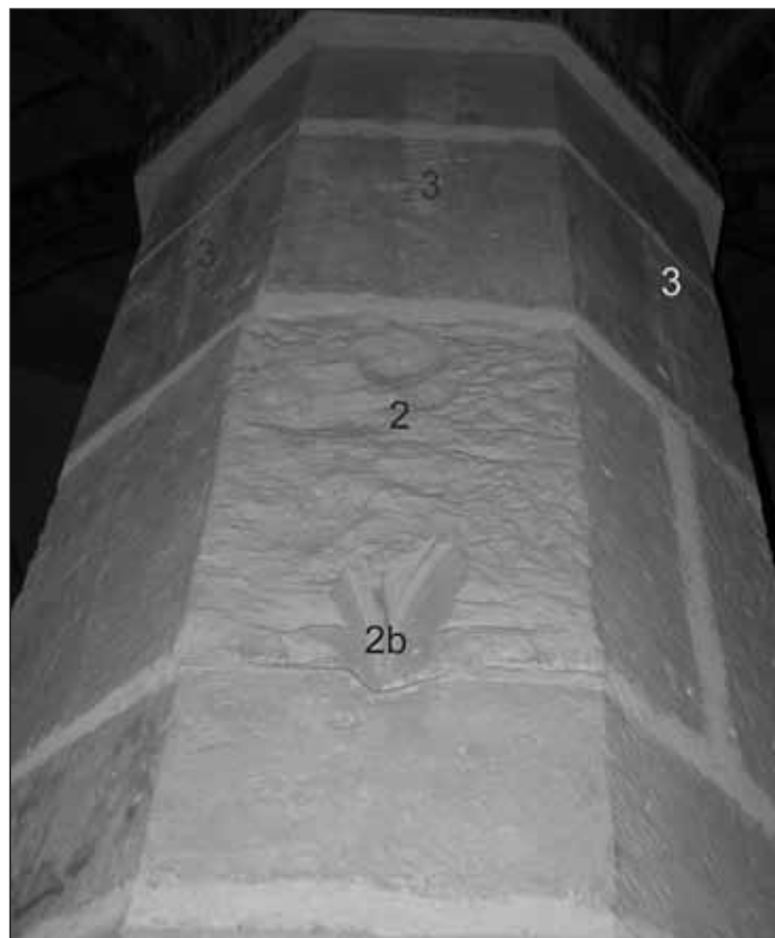
Obr. 8 Praha, Malá Strana. Kostel sv. Tomáše s klášteřem augustiniánů (čp. 28). Pohled na jižní sloup klenby kapitulní síně. Detail. 2 – stopy po odstraněném baldachýnu. 2b – zbytek profilace baldachýnu. 3 – jizva a zbytek nosíků po výběhu klenebních žeber.
