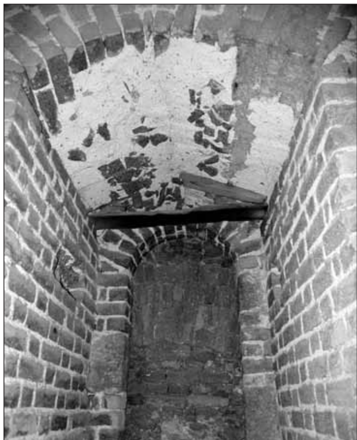
Obr. 14 Detail záklenku a pozůstatků bednění gotického vstupu v jižní stěně věže v úrovni 2NP. Foto archiv Archaia Brno o. p. s. 2007, i. č. 09539-2007.
