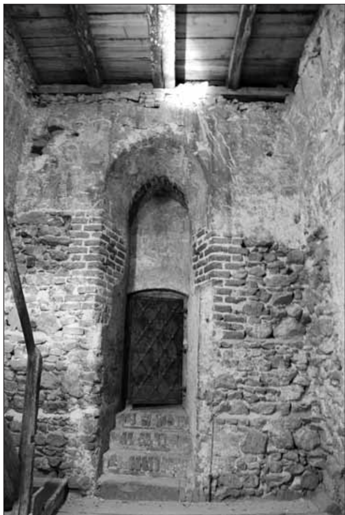
Obr. 19 Pozůstatek gotického okna v jižní stěně 4NP, barokně přezděný na vstup do podkrovní Lorety. Foto archiv Archaia Brno o. p. s. 2013, i. č. 19794-2013.
