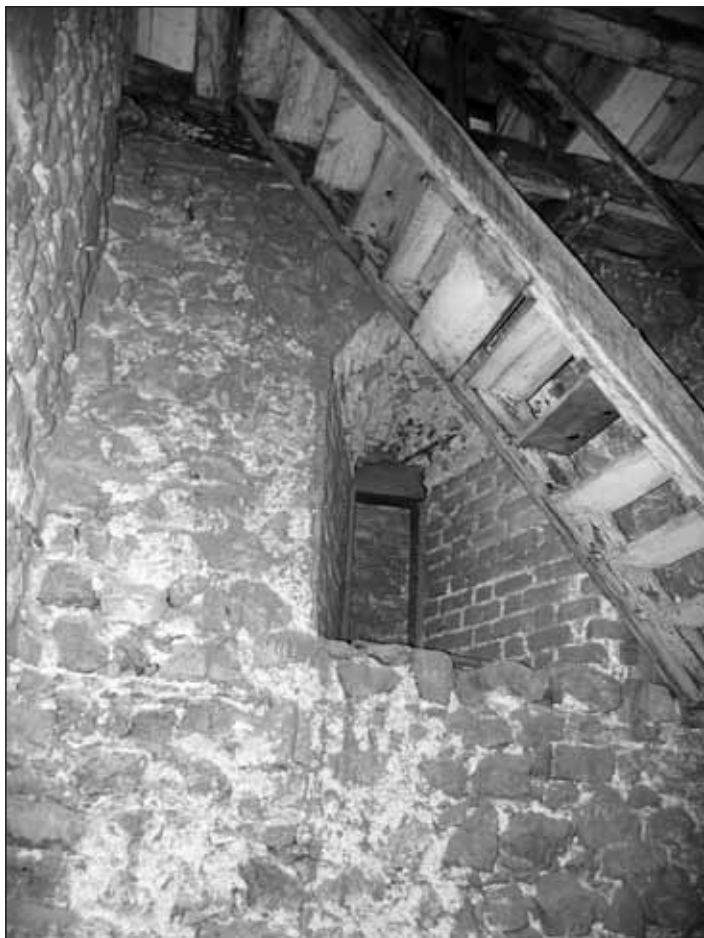
Obr. 16 Okno ve východní stěně v úrovni 3NP. Foto archiv Archaia Brno o. p. s. 2007, i. č. 09110-2007.
