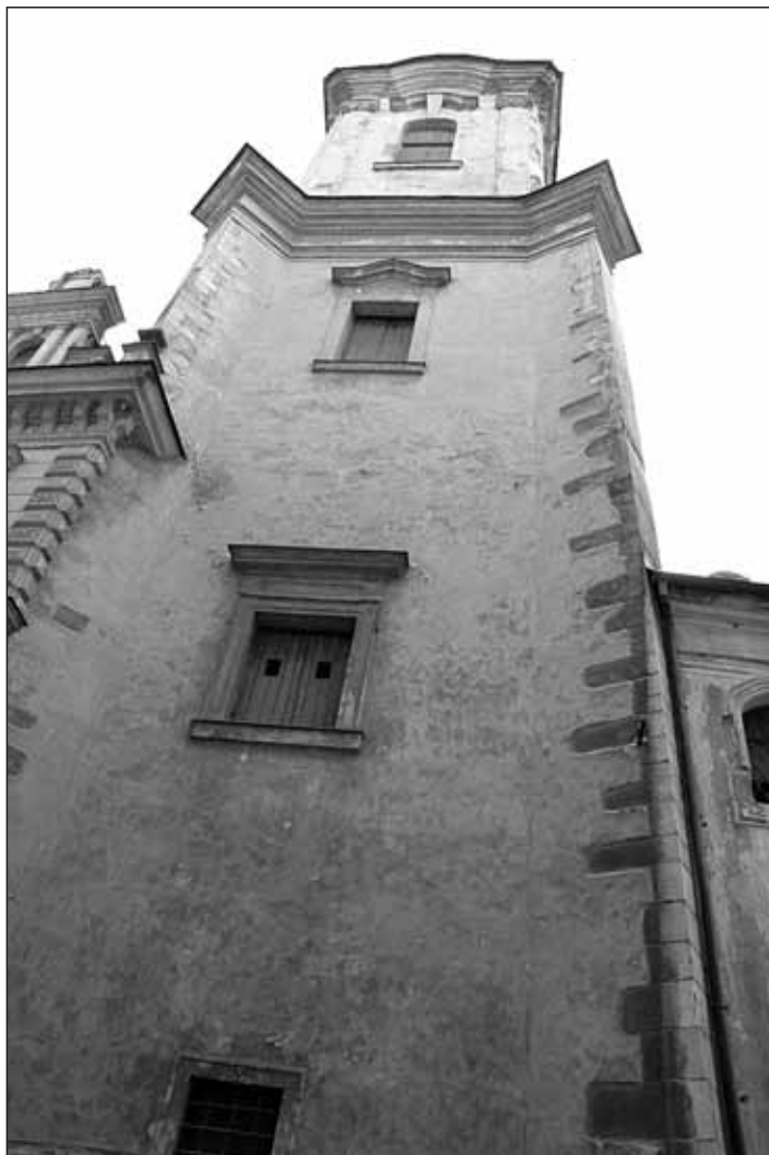
Obr. 6 Severní uliční fasáda. Foto archiv Archaia Brno o. p. s. 2004, i. č. 7804-2004.
