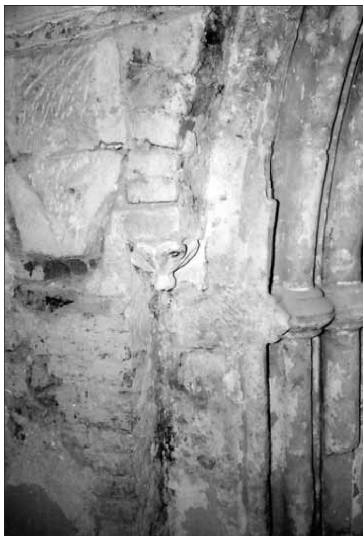
Obr. 5 Brno – minorité. Severní ostění portálu s konsolou vnějšího oblouku a stopami odsekanych prvků.
